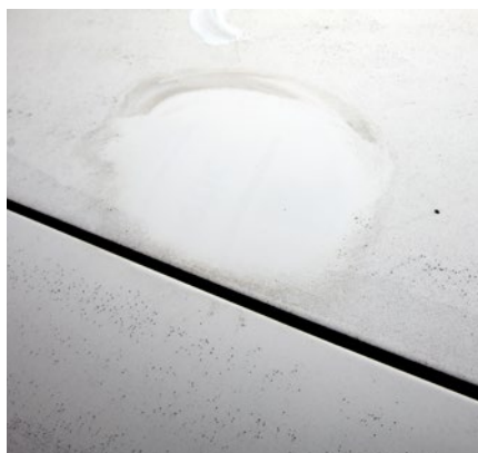
Lackzustand vor der Aufbereitung
